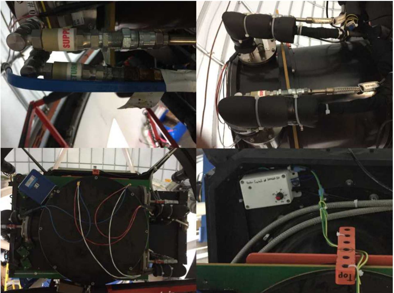
그림 10. 정온전선 컨트롤러를 카메라 메탈호스에 설치한 모습
