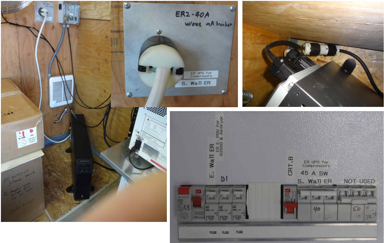
그림 24. 장비실 카메라 냉각기 콤프레셔 전용 UPS 설치 및 배전반 확인
